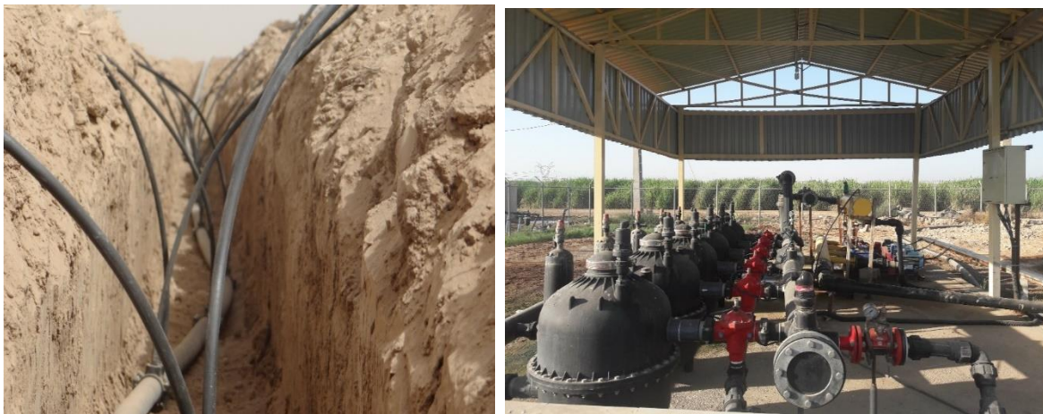
شکل ۱. ایستگاه فیلتراسیون (الف) و نحوه اتصال لوله آبدۀ به مانیفولد (ب)
