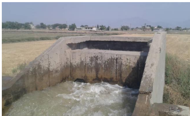
شکل ۱. خروجی ایستگاه پمپاژ سد گلستان و ابتدای شبکه آبیاری گلستان، خرداد ماه ۱۴۰۱
