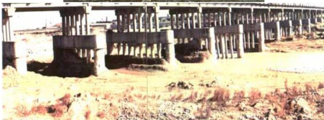
شکل ۱. نمایی از گودال ایجاد شده ناشی از برداشت شن و ماسه در رودخانه تالار و آبشستگی پایه‌های پل رودخانه تالار
